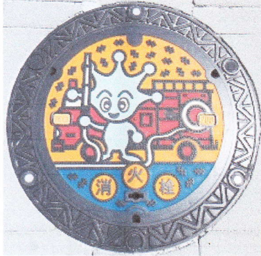
横須賀市(消火栓)
