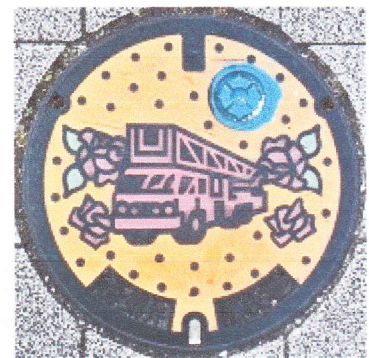
豊中市 空気弁(付)消火栓
