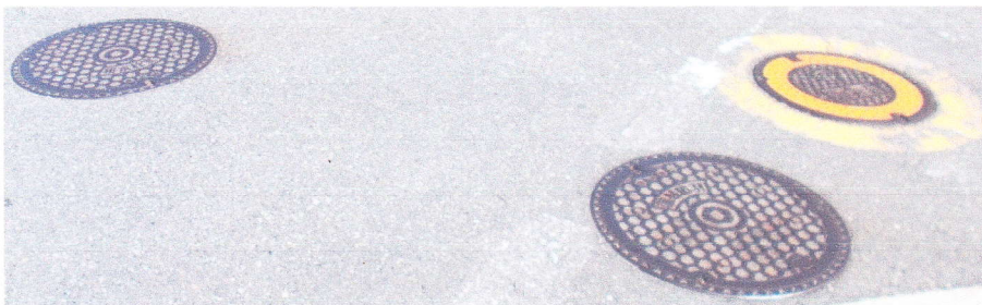
左: 豊中市 排水栓室
