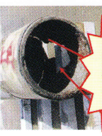
腐食が原因で下水道管に大きなひびが!
