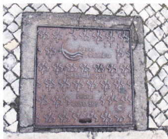
(3) 水道と下水兼用のマンホール
