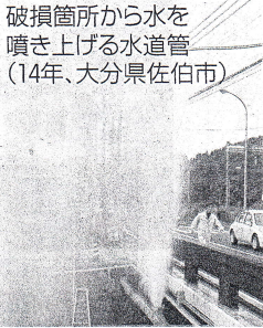
破損箇所から水を噴き上げる水道管(14年、大分県佐伯市)
