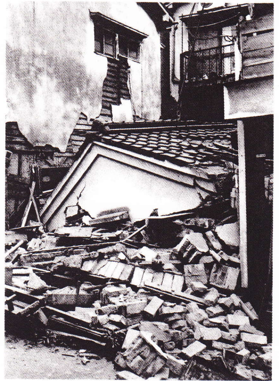
おそらく煉瓦造りの土蔵か何かだったと思うが、屋根の部分だけを残して完全に瓦解している。瓦屋根がどれほど重いかうかがえる。
