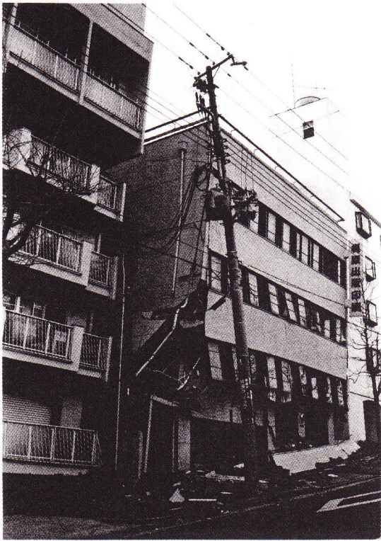
いっけん被害がなさそうに見える鉄筋4階建てのビル。だがよく見ると、2階部分がつぶれて、3階から上が道路側にせり出している。
