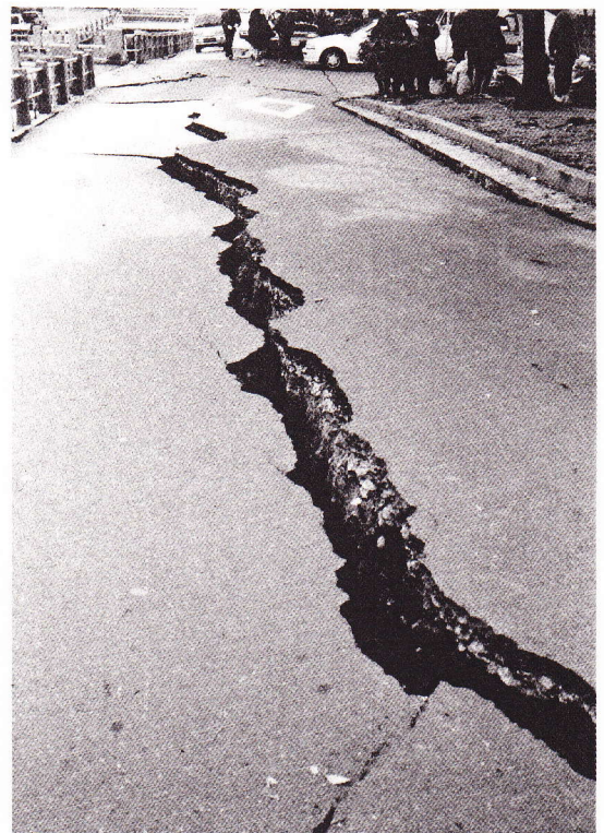
川沿いの側道に大きく走る亀裂。縦方向に10cm以上、横方向には30cm近くのズレがあり、断層が大きく動いたことを物語っている。
